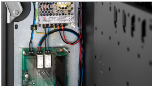
Verkabelung nach VDE-Richtlinien
